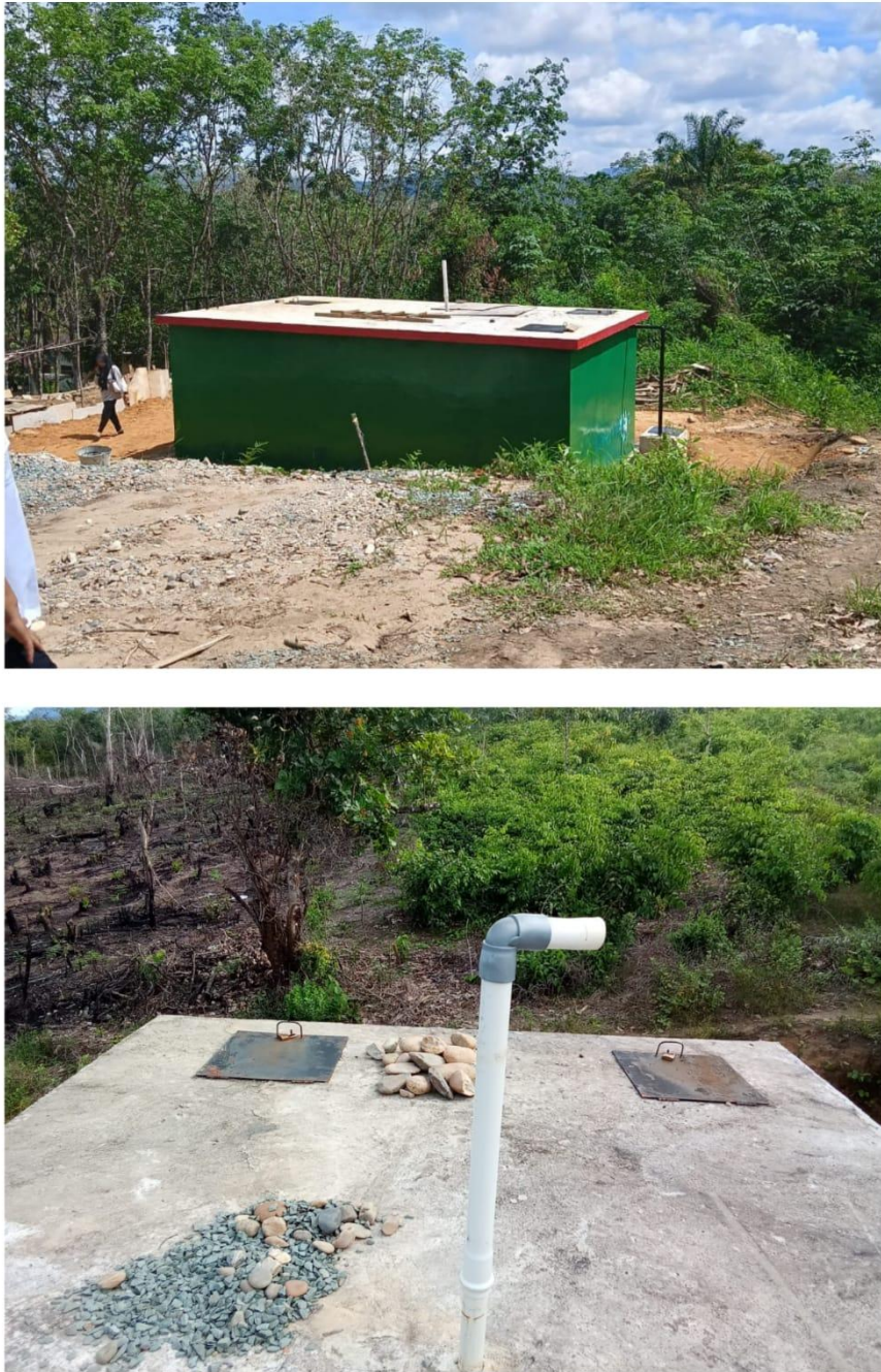
Gambar 4. Bak Penampungan air yang tertutup untuk menghindari resiko kontaminasi dari luar
