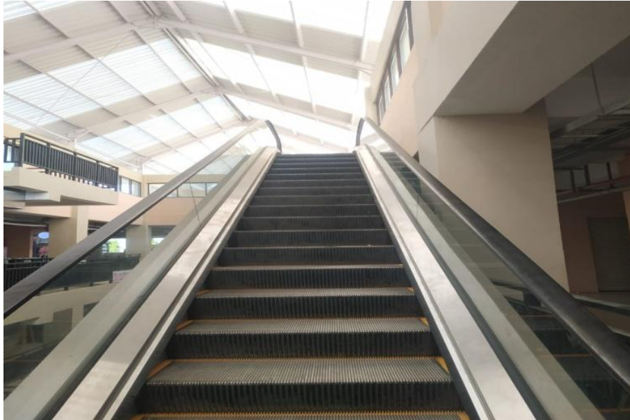
Gambar 1. Kondisi eskalator di Gedung Pasar Raya Fase VII
