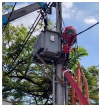
Gambar 2. Trafo Distribusi GT.PTP001
